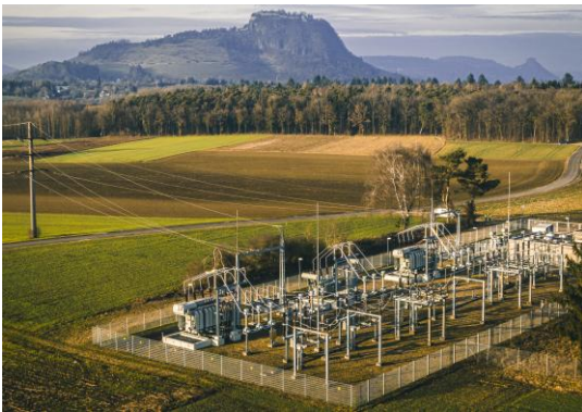
Abb.6 Umspannwerk in der Region Hegau
